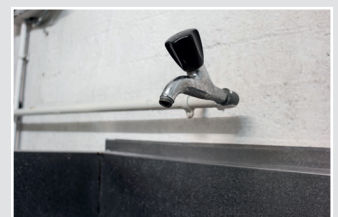
Endständige Leitungen, die fast nie benutzt werden.
